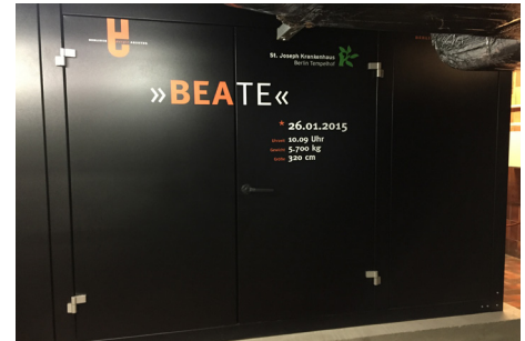
Installiertes BHKW © Berliner NetzwerkE, Dietmar Gust
